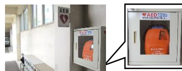
本館 1,2 棟間 1 階東通路AED
